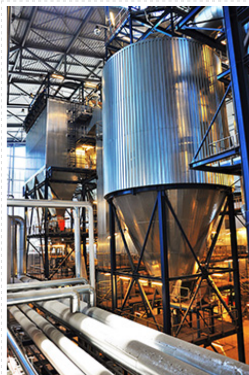
WĘZEŁ OCZYSZCZANIA SPALIN
