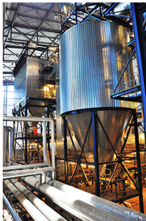
WĘZEŁ OCZYSZCZANIA SPALIN
