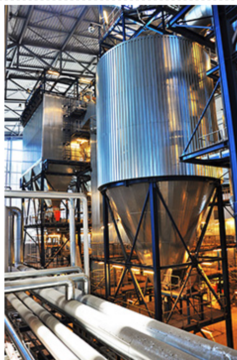
WĘZEŁ OCZYSZCZANIA SPALIN
