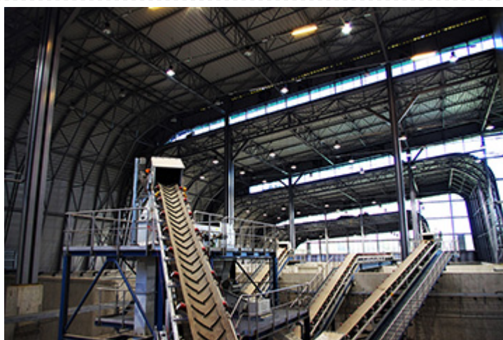
WĘZEŁ WALORYZACJI ŻUŻLA
